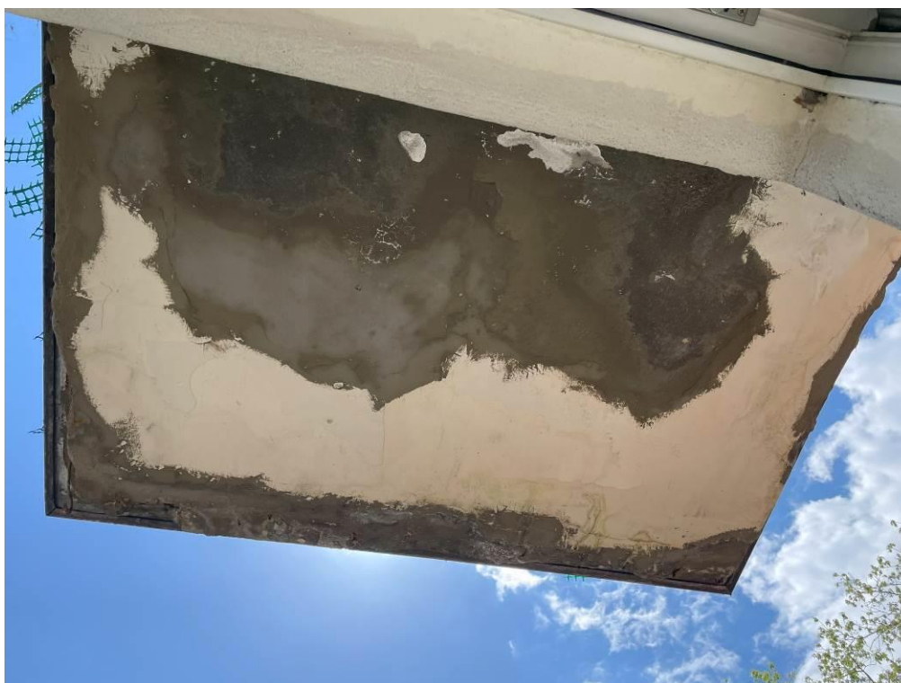
Fot. 3. Widok uszkodzeń płyty balkonowej od spodu.
