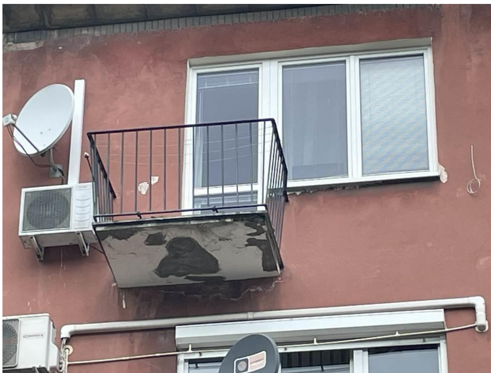
Fot. 2. Widok uszkodzeń płyty balkonowej.
