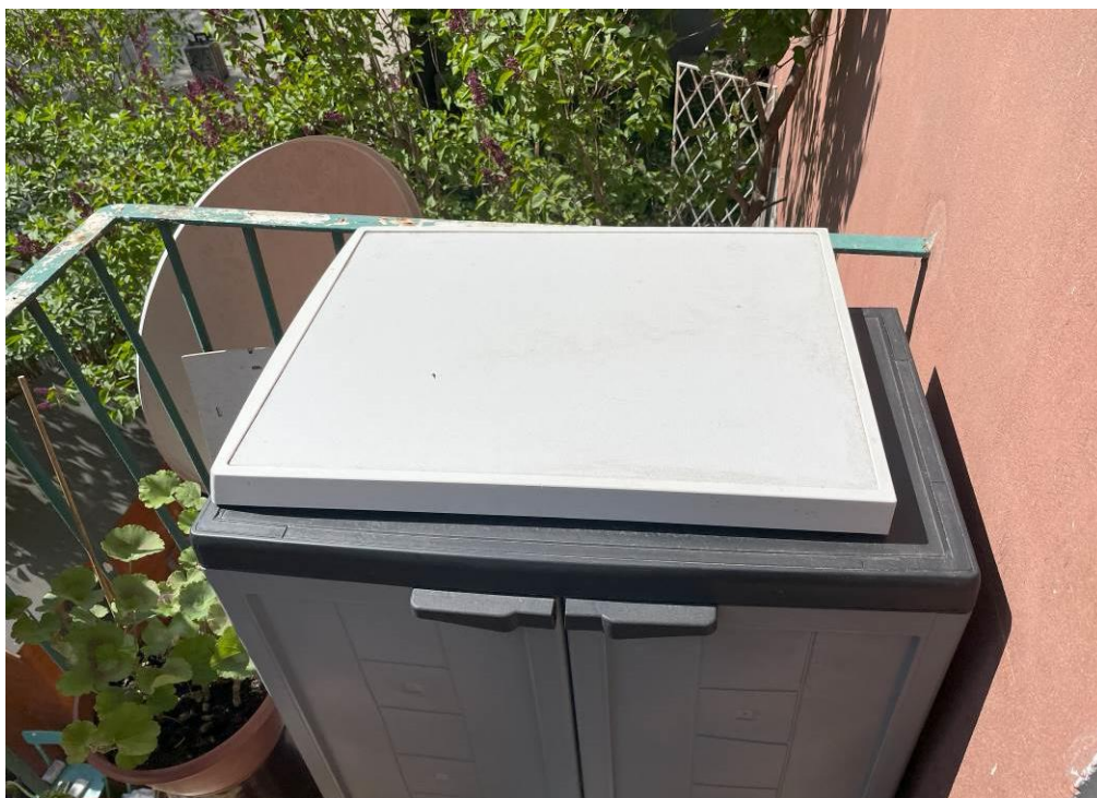
Fot. 5. Widok uszkodzeń balustrady balkonowej.
