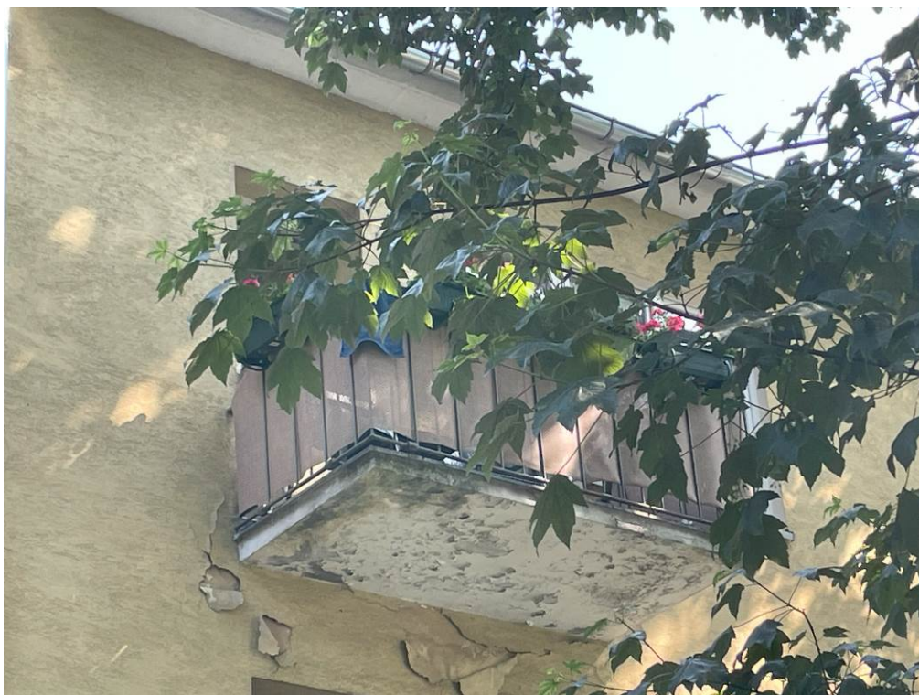
Fot. 3. Widok uszkodzeń płyty balkonowej.
