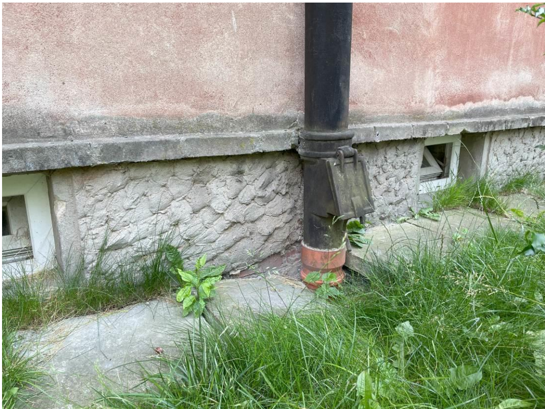
Fot. 3. Widok uszkodzeń opaski budynku.
