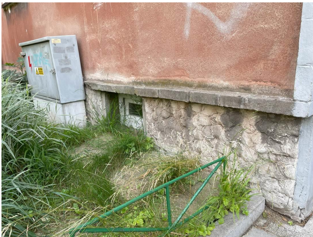
Fot. 4. Widok zawilgoceń w rejonie cokołu.
