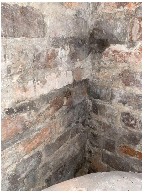
Fot. 2. Widok wysoleń na ścianie w piwnicy narożnej w klatce nr 5.
