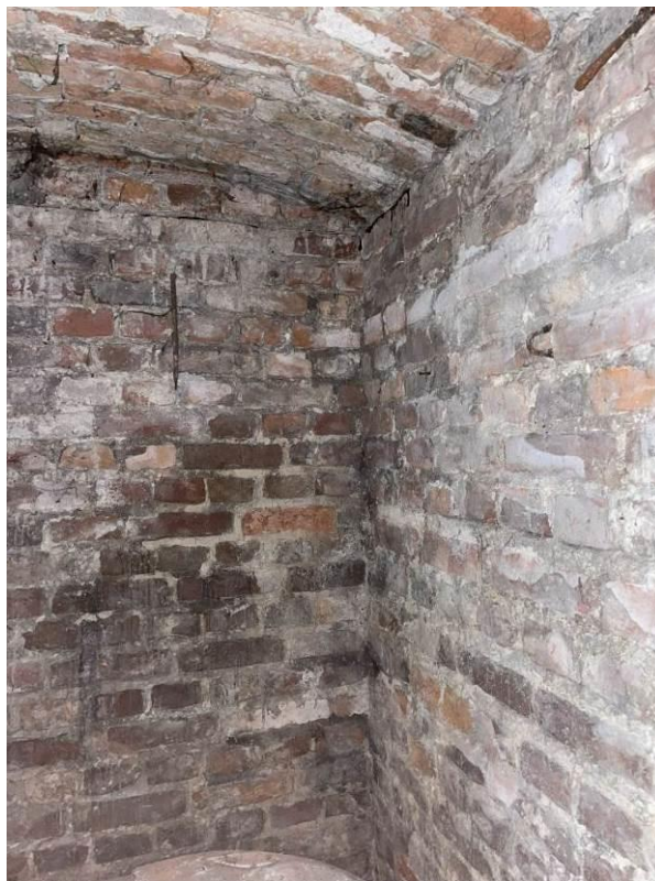
Fot. 1. Widok zawilgocenia ściany w piwnicy narożnej w klatce nr 5.
