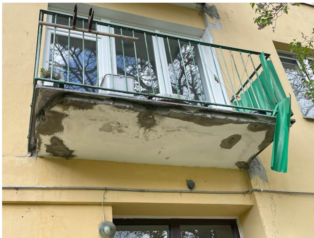
Fot. 3. Widok uszkodzeń płyty balkonowej.
