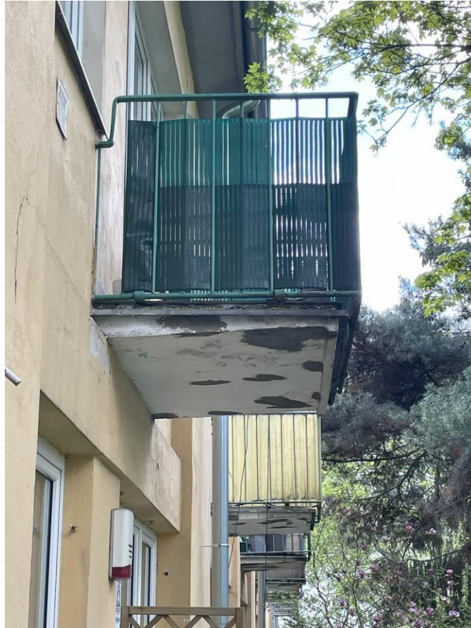
Fot. 4. Widok uszkodzeń płyty balkonowej.
