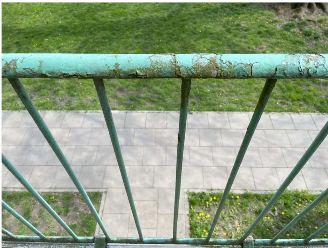
Fot. 6. Widok uszkodzeń balustrady balkonowej.
